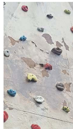
Łuszcząca się farba na ścianie
