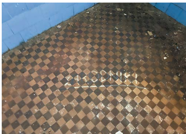
FOT. 11 Zarodniki strocza domowego pokrywające posadzkę; fot.: autor
