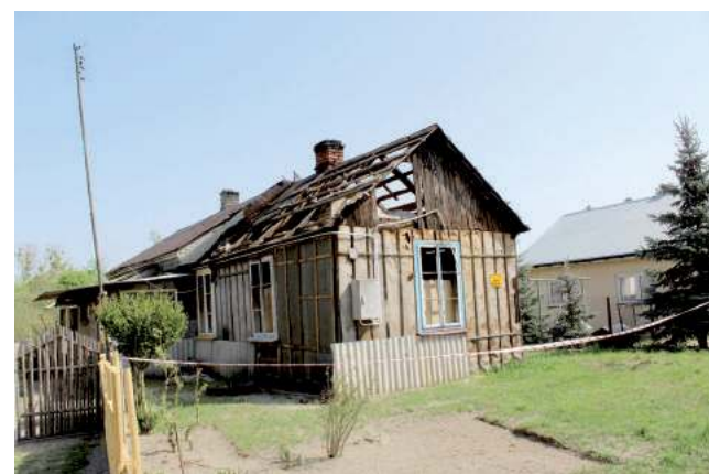
Połowa domu po pożarze nadaje się wyłącznie do rozbiórki
