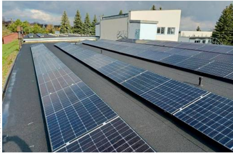
Panele na dachu budynku Zakładu Wodociągów i Kanalizacji już produkują prąd
