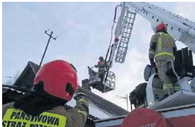
Strażacy z Przysuchy zabezpieczali w niedzielę dach uszkodzony przez wichurę w miejscowości Ruski Bród.
