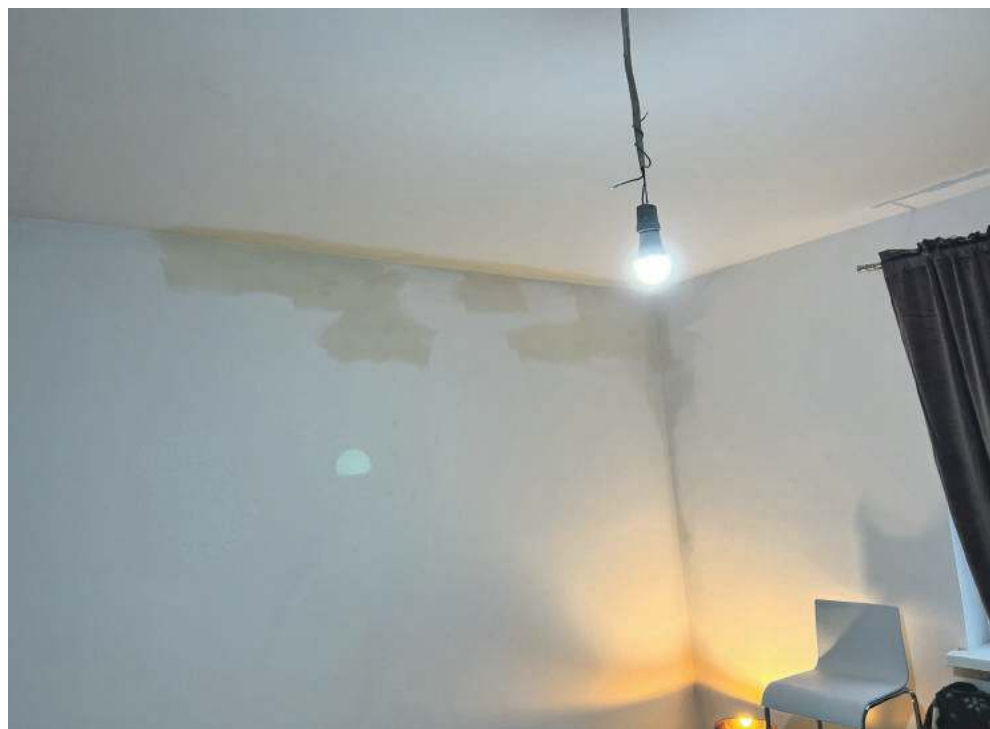
Na ścianach w mieszkaniu widać ogromne zacieki
