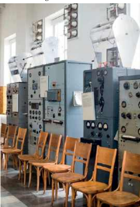
Kilka nadajników krótkofalowych stacji radiowej Grimeton
