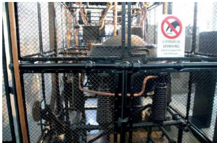
Część transformatorów nadajnika stacji radiowej Grimeton
