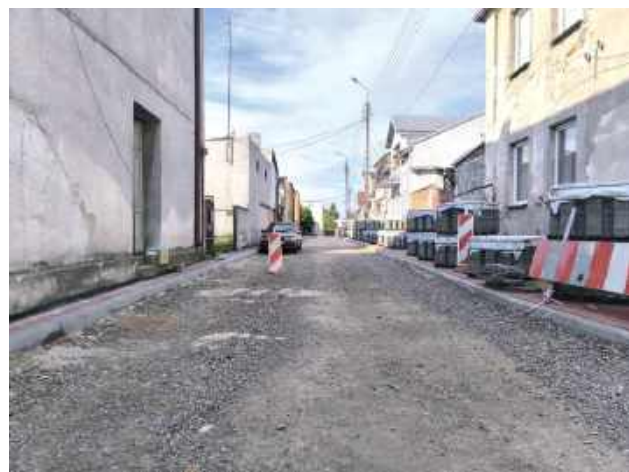
Niektóre drogi pilnie wymagały remontu
