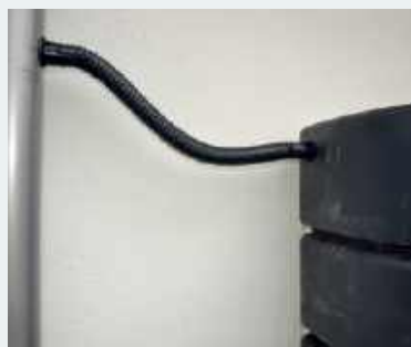
❷ Przy rurach spustowych, zamontowano naziemne zbiorniki na deszczówkę.
