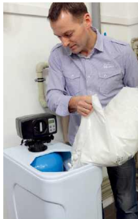
🔹 Jednymi z najczęściej montowanych urządzeń do uzdatniania wody są zmiękczacze. Trzeba do nich regularnie dosypywać tabletki soli. ust-m
