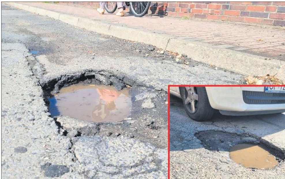
Dziura w drodze na ul. Krasickiego w Krapkowicach zagraża użytkownikom ruchu.
