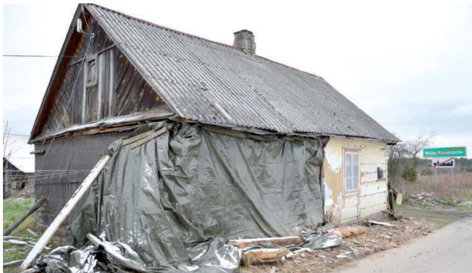
W ścianie domu powstała ogromna dziura. Strażacy podstawili pod drewniane belki utrzymujące konstrukcję budynku podporę. A dziurę zakryli plandeką
