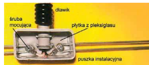
Rys. 3. Umocowanie i połączenia w puszcze instalacyjnej. Pod spodem znajduje się płytkę z pleksiogalu
