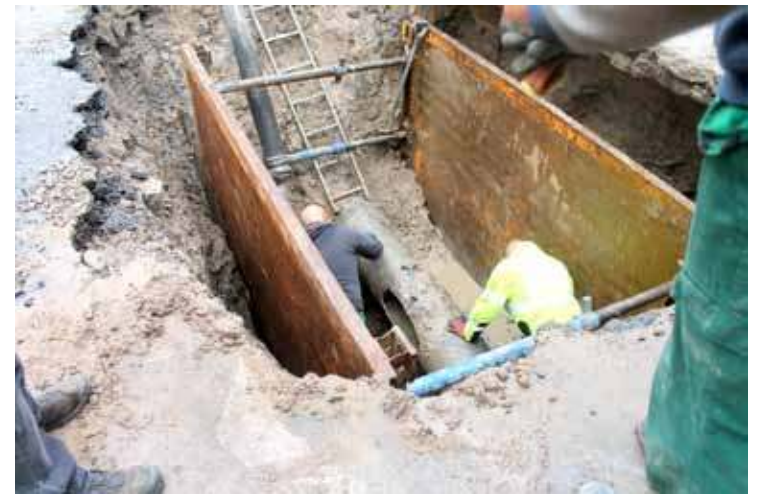
Ekipa MPGK usunęła sporą usterkę w postaci dziury i dokonała następnie połączenia rur
