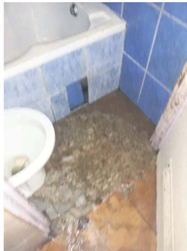
W budynku doszło do zatkania kanalizacji, w wyniku czego łazienka i kuchnia jednej z lokatorek została zalana fekaliami
