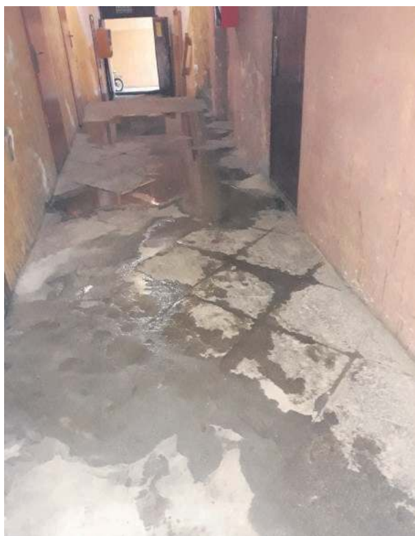
Tak wygląda korytarz na parterze w „belwederze”. Na betonowej podłodze zalegają ścieki
