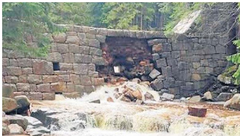
Tak wyglądała wczoraj rozerwana zaporą na Łomnicy
