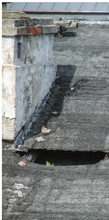
Kępna 11: drzewa samosiejki na elewacji, dziura w dachu i otwarta kłapa wjazdu na dach | fot. Janusz Sujecki/Gazeta Polska
