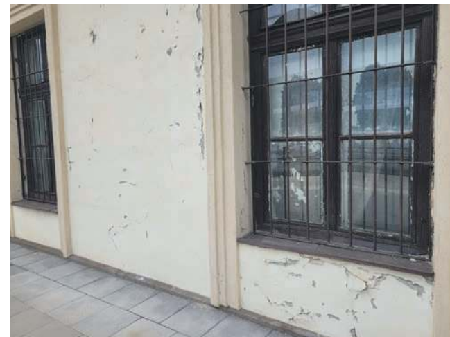
Podmalowana w 2016 roku elewacja dworcowego budynku się sypie. Okna też
