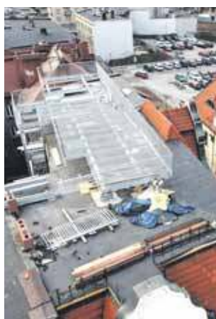
Konstrukcja, którą zamontowano na dachu kamienicy, to nie taras widokowy. Ma zupełnie inne przeznaczenie
