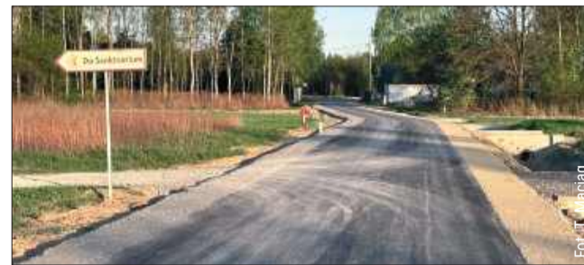
Przypomnijmy, że trakt łączący ul. Książ z ul. Jana Pawła II, pokryty nawierzchnią asfaltową, został oddany do użytku w tym roku
