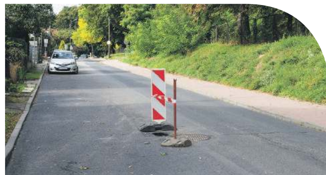
Wyrwa na ul. Konopnickiej
