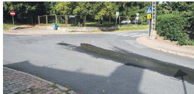
Ciekąca uszczelnienie zaworu na skrzyżowaniu ul. Wojska Polskiego i ul. Konopnickiej
