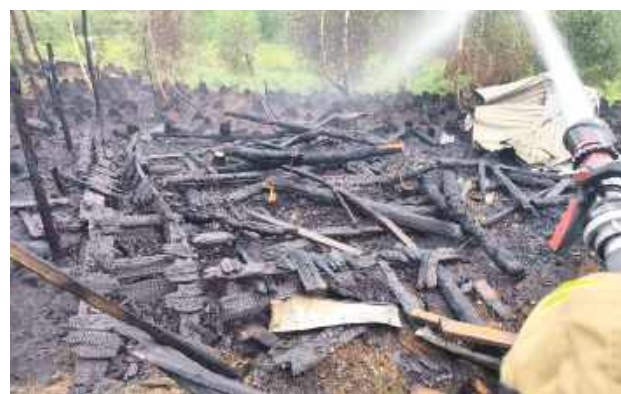
Konstrukcja uległa całkowitemu zniszczeniu
