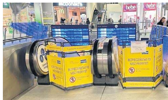
Ruchome schody na dworcu PKP Bydgoszcz Główna nie działają od czerwca 2025 roku
