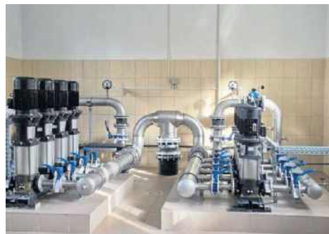
System wodociągowy gminy Miedziana Góra zostanie zabezpieczony przed cyberzagrożeniami
