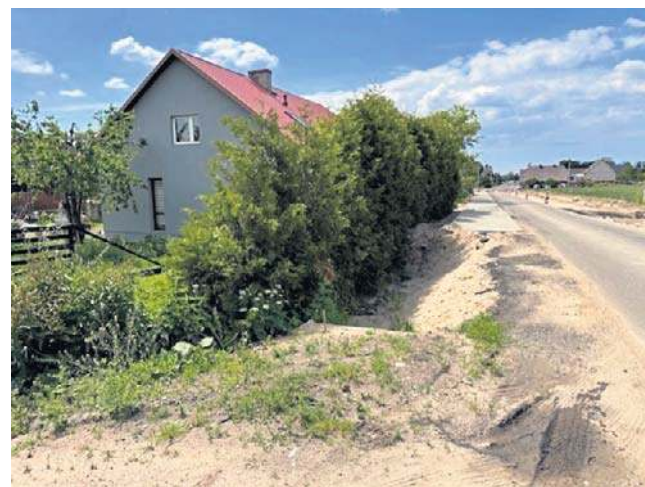
... a tak wygląda część drogi, na której początkowo nie przeprowadzono niezbędnych robót
