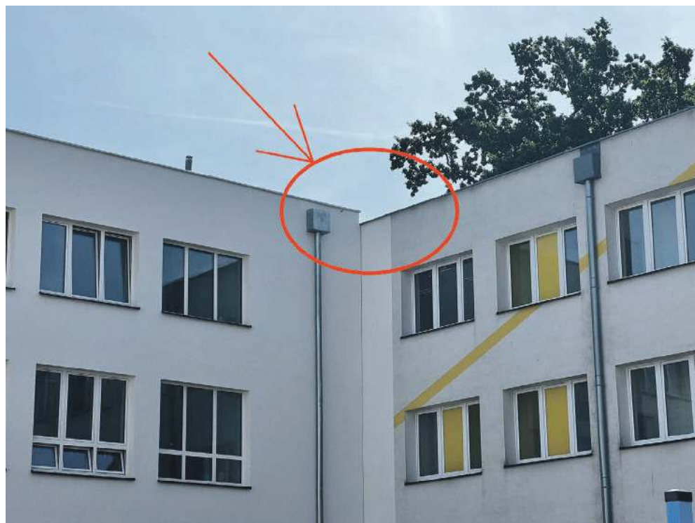
Inspektor wskazał, że poziomy korytarz nie są spasowane i powstały pochylnie. Na zdjęciu widać, że nowe skrzydło jest wyższe od starej części szkoły
