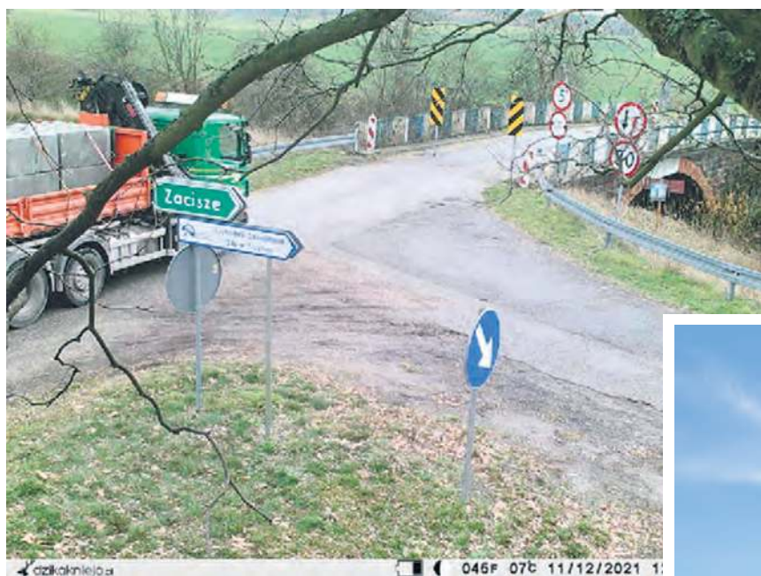
Przez wiadukt cały czas próbują przejeżdżać ogromne i ciężkie maszyny. Fot. ZDP
