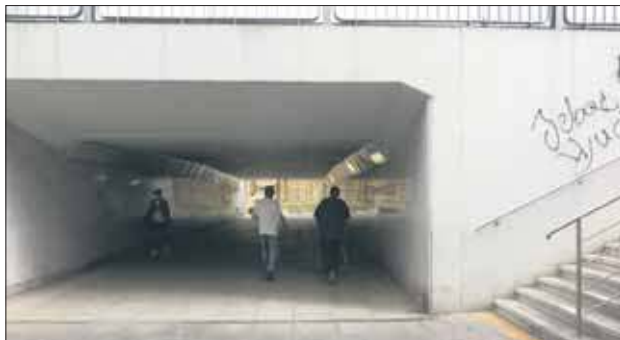
Mieszkańcy wnoszą wiele uwag co do stanu przejścia
