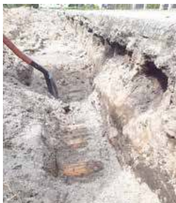
To te niepozorne zakopane głęboko belki wstrzymały przebudowę drogi wojewódzkiej w Stepnicy
