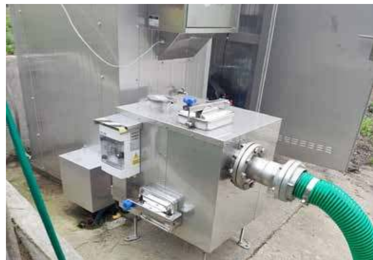
Zlewnia ścieków pozwala na badanie składu ścieków, nim te trafią do zbiornika
