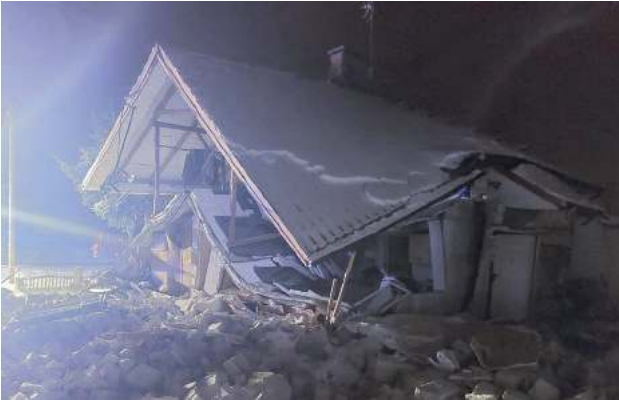
Joanna Niecko W budynku zawalił się dach. Jedna osoba poszkodowana
