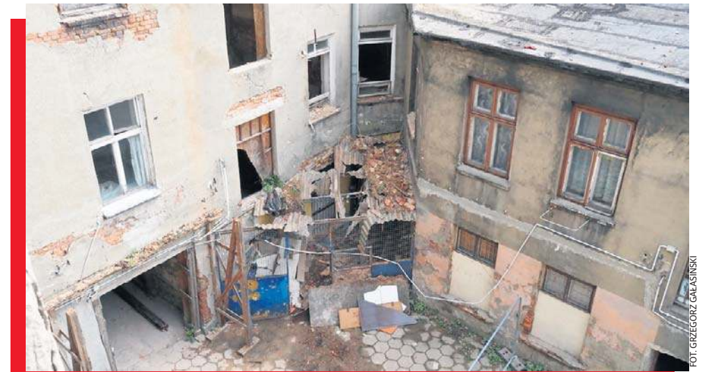
Do katastrofy budowlanej doszło w rozbieranej, frontowej części kamienicy przy ul. Zgierskiej 74. Ale w oficynach nadal mieszkają ludzie.
