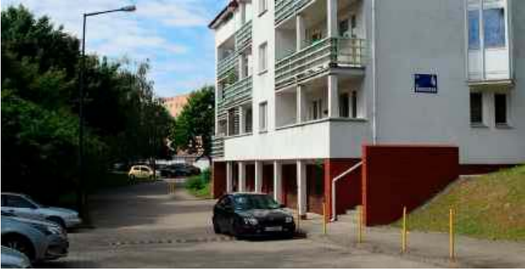
Dziś po każdej ulewie woda spływająca ulicą Krokusową zalewa garaże i piwnice pod blokiem nr 6. Miasto deklaruje, że pomoże spółdzielni rozwiązać ten problem
