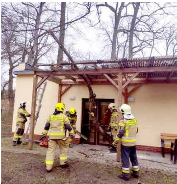
W Ziemomyślu A złamane konary drzewa uszkodziły zadaszenie niewielkiego tarasu przed świetlicą wiejską. Foto. OSP. Dolice
