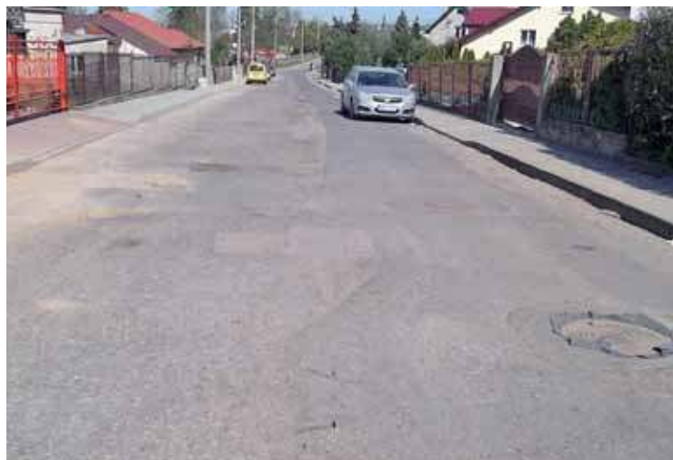
Ul. Okólna po kanalizacji wymaga nowej nawierzchni, na co niecierpliwie czekają mieszkańcy
