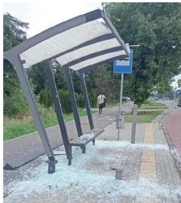
Wiat przystankowa przy rondzie w Łuccie, w pobliżu wjazdu do Lubartowa została uszkodzona. Do zdarzenia doszło w nocy z soboty na niedzielę. Policja prowadzi postępowanie w kierunku kolizji. Sprawca na razie jest nieustalony, ślady wskazują, że w wiatę mogła uderzyć naczepa samochodu ciężarowego
