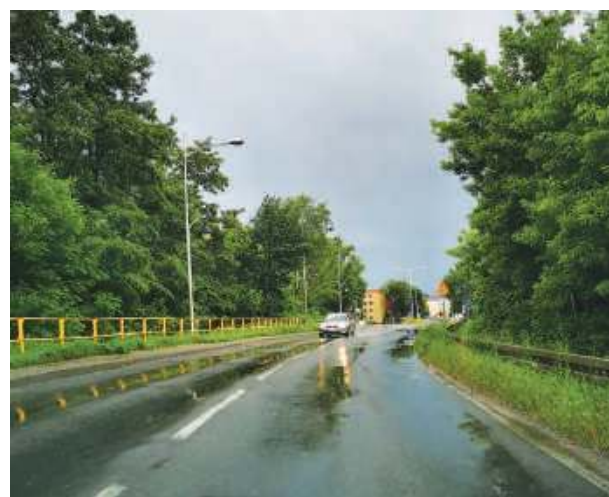
Na ul. Morawicza po deszczu tworzą się głębokie kałuże
