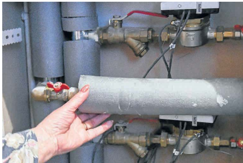
Mieszkańcy zwracają uwagę, że po zakończeniu prac instalatorskich liczniki nie zostały wyzerowane
