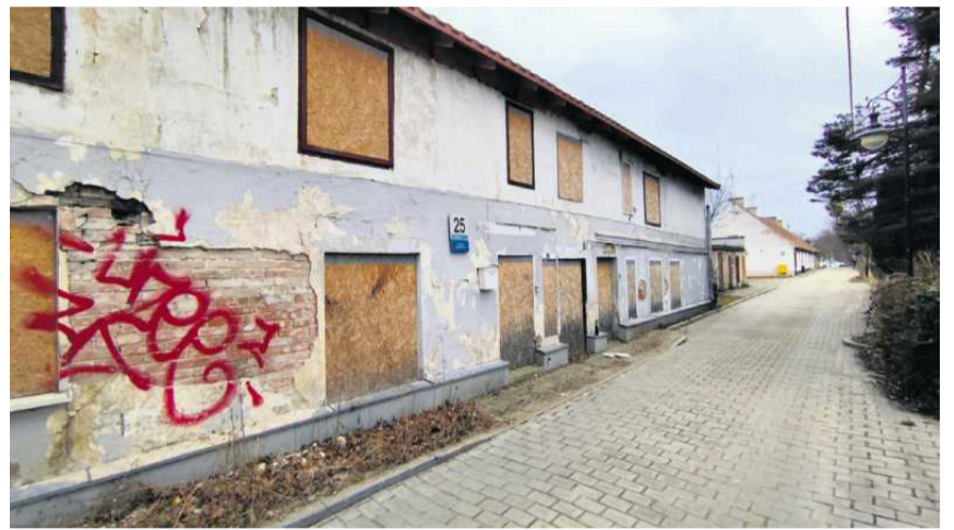
• Budynki należą do miasta, które od lat nie potrafi ich wyremontować
