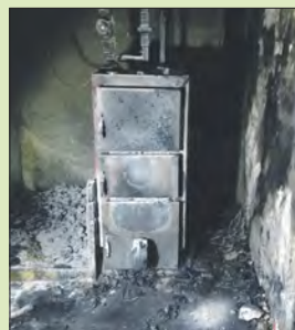
Spalona część kotłowni
