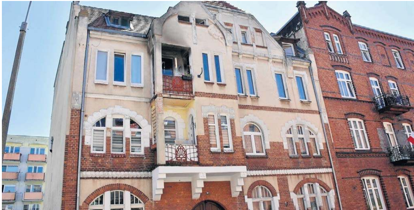
Do pożaru doszło na drugim piętrze tej kamienicy. Droga ucieczki była odcięta przez podłożony ogień. Dwie kobiety i dwoje dzieci strażacy ewakuowali w koszu drabiny
