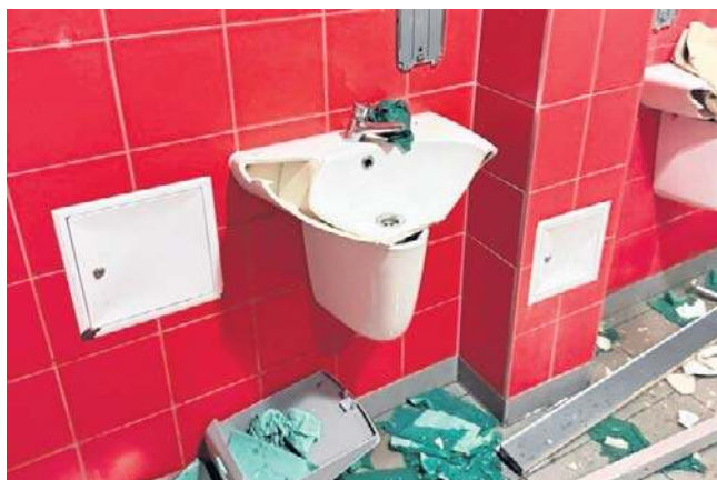
Tak wyglądały pomieszczenia sanitarne na stadionie Widzewa po przejściu poznańskiego tornado
