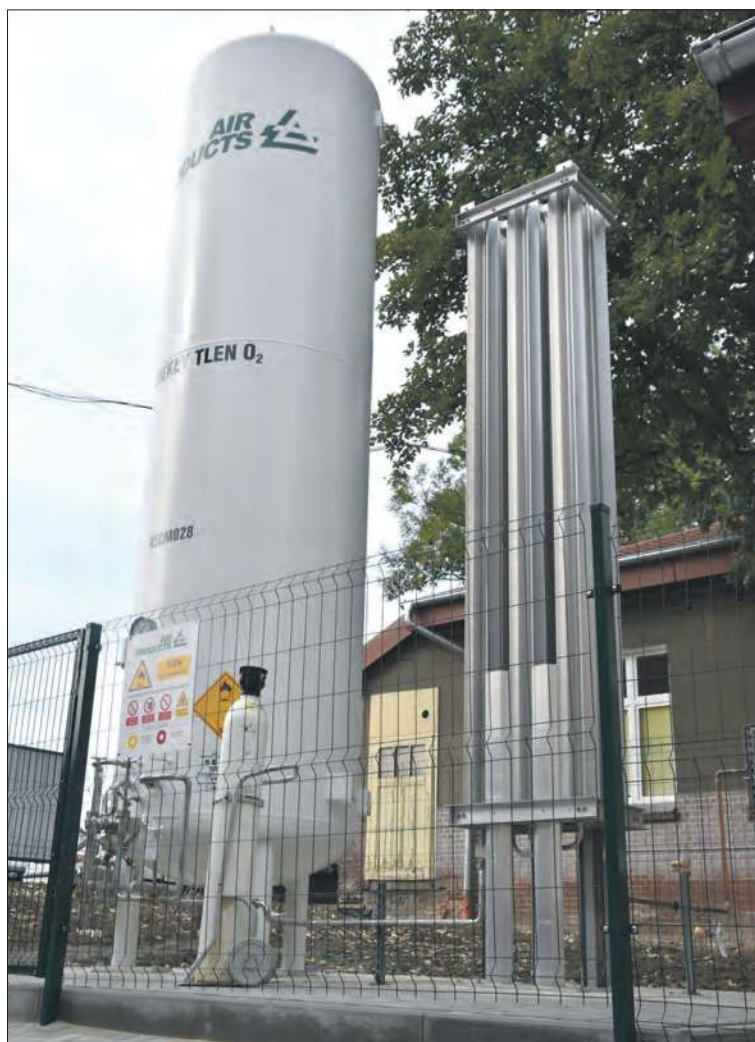
Nowoczesna instalacja tlenu
