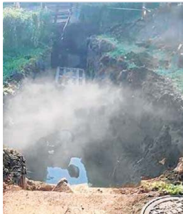
Gorąca woda wylewa się na zewnątrz z pękniętej rury
