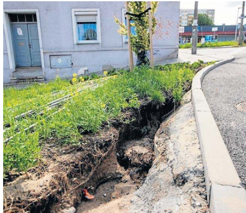
Zniszczony został również teren zielony przy jezdni
