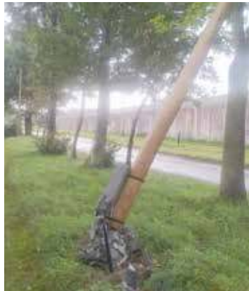
Po niedługim czasie od uruchomienia sieci doszło do pierwszych uszkodzeń
