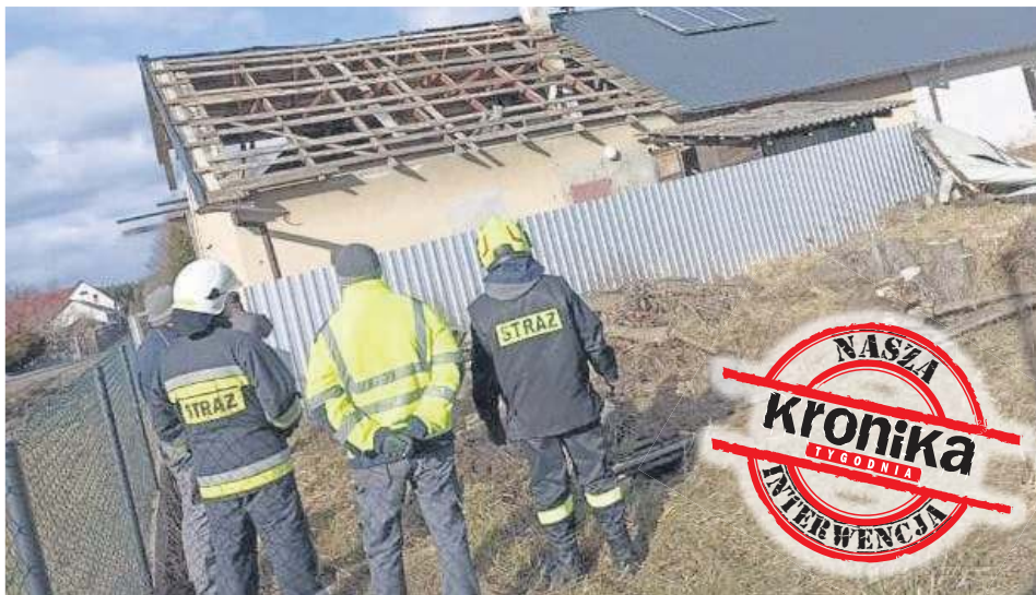
Strażacy z bólem serca patrzą, jak budynek remizy niszczeje.
