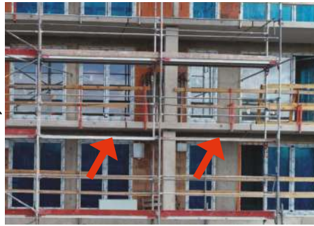
Rys. 4. Widok ogólny na fragment konstrukcji rusztowania budowlanego – strzałkami zaznaczono brakujące deski krawężnikowe
