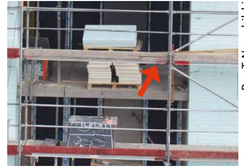
Rys. 5. Widok na uszkodzoną deskę krawężnikową
