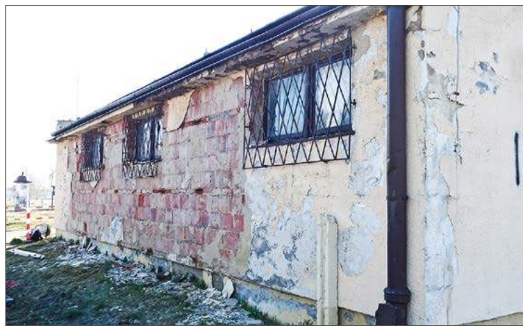
Ostatnio z jednej ze ścian odpadła elewacja. Prawie cała.
