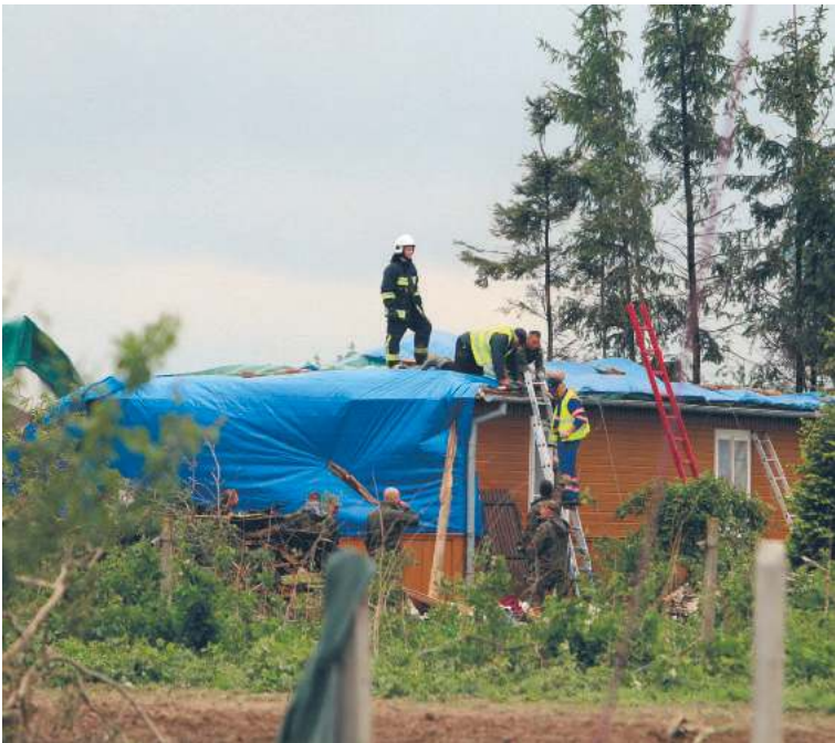
Zerwany dach nad jednym z domów w Palikijach
