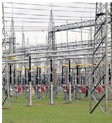
Linie energetyczne w pobliżu elektrowni w Bergheim na zachodzie Niemiec
