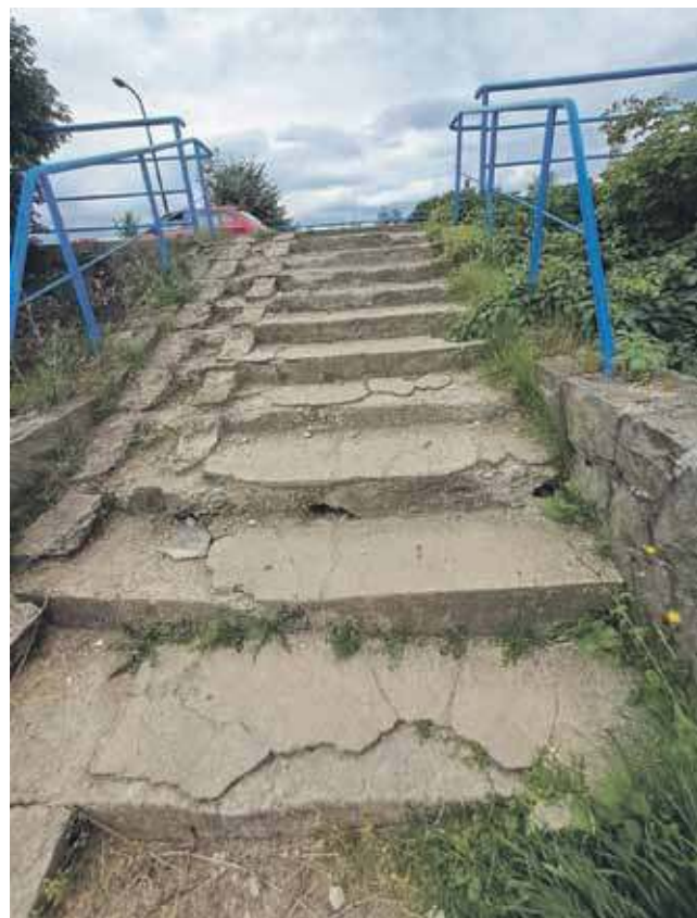
I kto ma wyremontować te schody?
